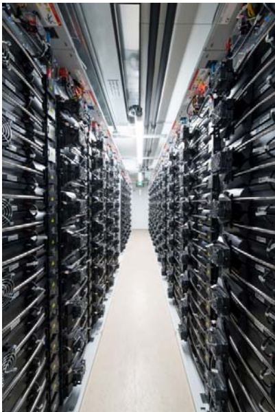
電力貯蔵システム（BESS）
