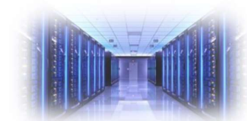
データセンター
