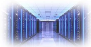
データセンター
