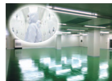
■半導体プロセス装置組立クリーンルーム Assembly of Semiconductor process equipment in clean room
