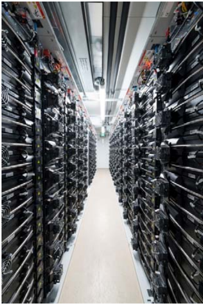
电能储存系统（BESS）
