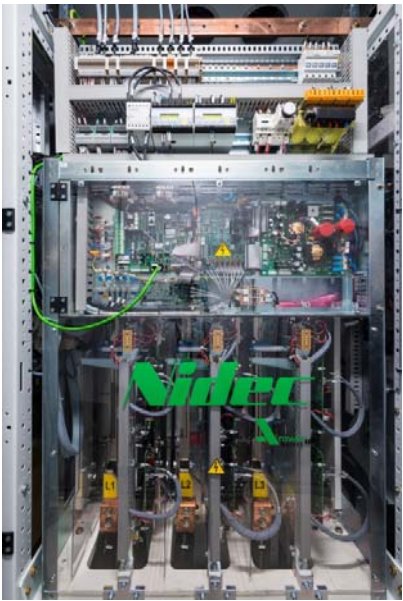
BESS 中必不可少的电能转换系统
