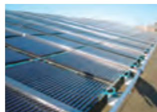
ソーラーシステム(太陽熱温水器)
