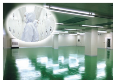
■半導体プロセス装置組立クリーンルーム
